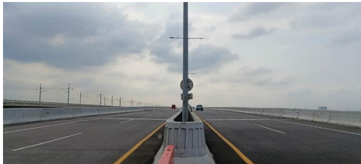
Gambar I.3 Kondisi Ruas Jalan MBZ
