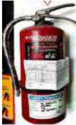
Gambar IV. 12 Kartu Inspeksi APAR Sumber : Dokumentasi Penyusun, 2021
