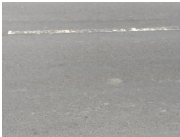
Gambar 5. 30 Kondisi Eksisting Marka Tengah Yang Memudar (Sumber: Hasil Survei, 2019)
