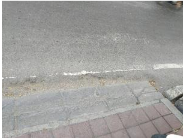
Gambar 5.29 Kondisi Eksisting Marka Tepi Yang Memudar (Sumber: Hasil Survei, 2019)
