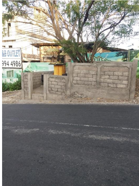
Gambar 5. 52 Kondisi Eksisting Marka Tengah Yang Memudar (Sumber: Hasil Survei, 2019)
