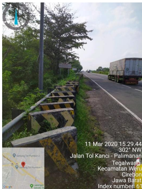
Gambar IV.2 Gambar hazard di bahu jalan
